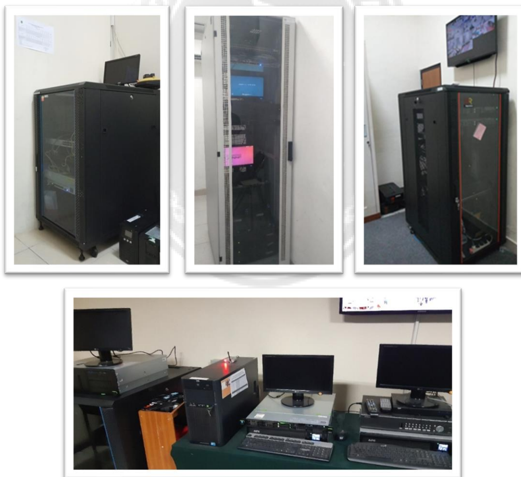
Gambar 4.3.1 Server Pengadilan Tinggi dan Pengadilan Negeri se Wilayah D.I. Yogyakarta
